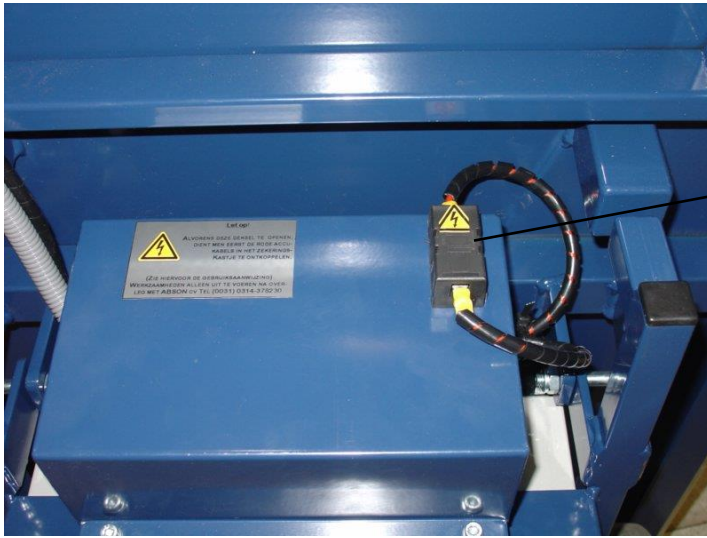
Zekeringskast Zie Pijl
